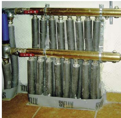
▲ Rozdzielacz, dzięki któremu poszczególne grzejniki otrzymują wymaganą ilość ciepłej wody
