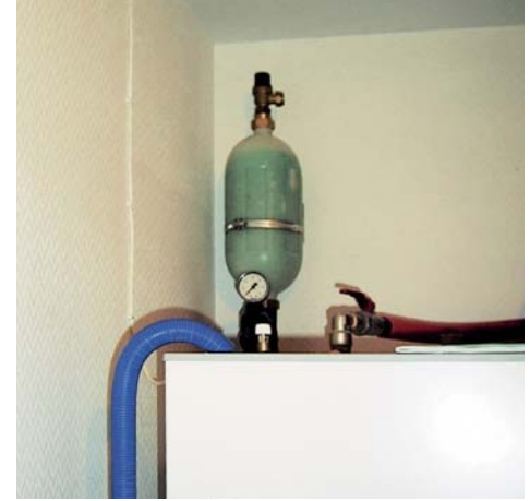
▲ Zbiorniczek wyrównawczy glikolu krążącego w kolektorze pompy ciepła
