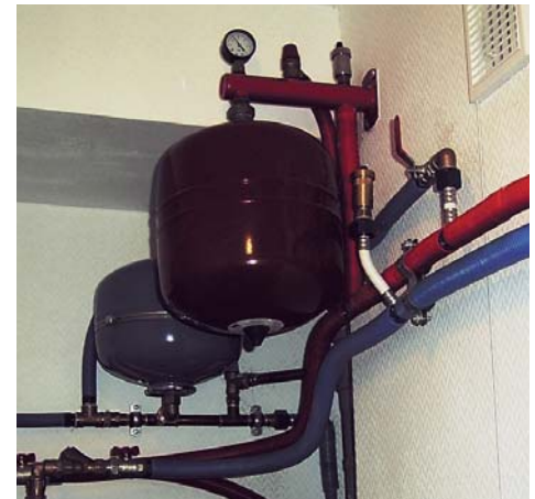
▲ Ważnym elementem instalacji grzewczej jest armatura zabezpieczająca
