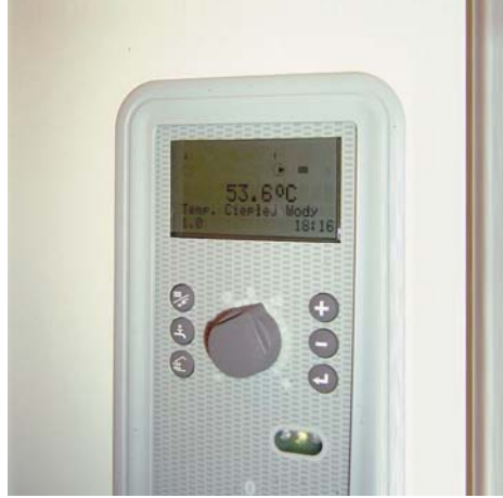
▲ Wyświetlacz, na którym można prześledzić nie tylko bieżące parametry pracy pompy ciepła, ale również całą historię jej działania od momentu uruchomienia
