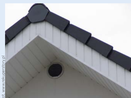
Czerpnia powietrza umieszczona pod okapem
