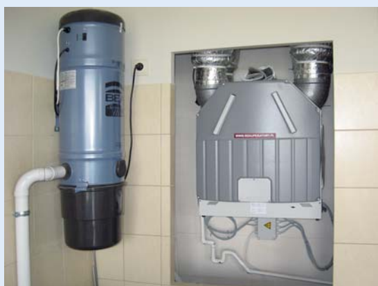
Centralę wentylacyjną można zamontować np. w garażu, tuż obok odkurzacza centralnego
