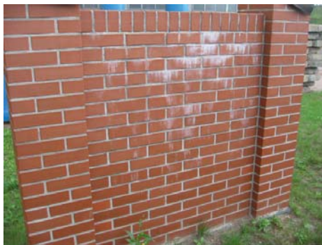
Fot. 1. Murek zbudowany na cementowej zaprawie (bez wapna) do klinkieru.
