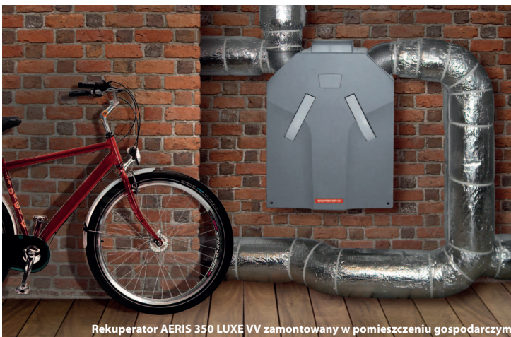
Rekuperator AERIS 350 LUXE VV zamontowany w pomieszczeniu gospodarczym
