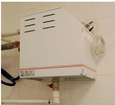
▲ Wydajna wytwornica pary zainstalowana jest w części gospodarczej domu i obsługuje łaźnię parową w pomieszczeniu rekreacyjnym
