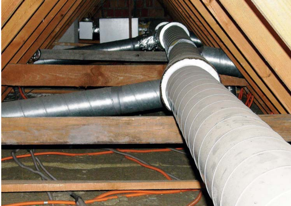
▲ Warto pamiętać, że poddasze nieużytkowe to świetne miejsce do ułożenia różnego typu instalacji
