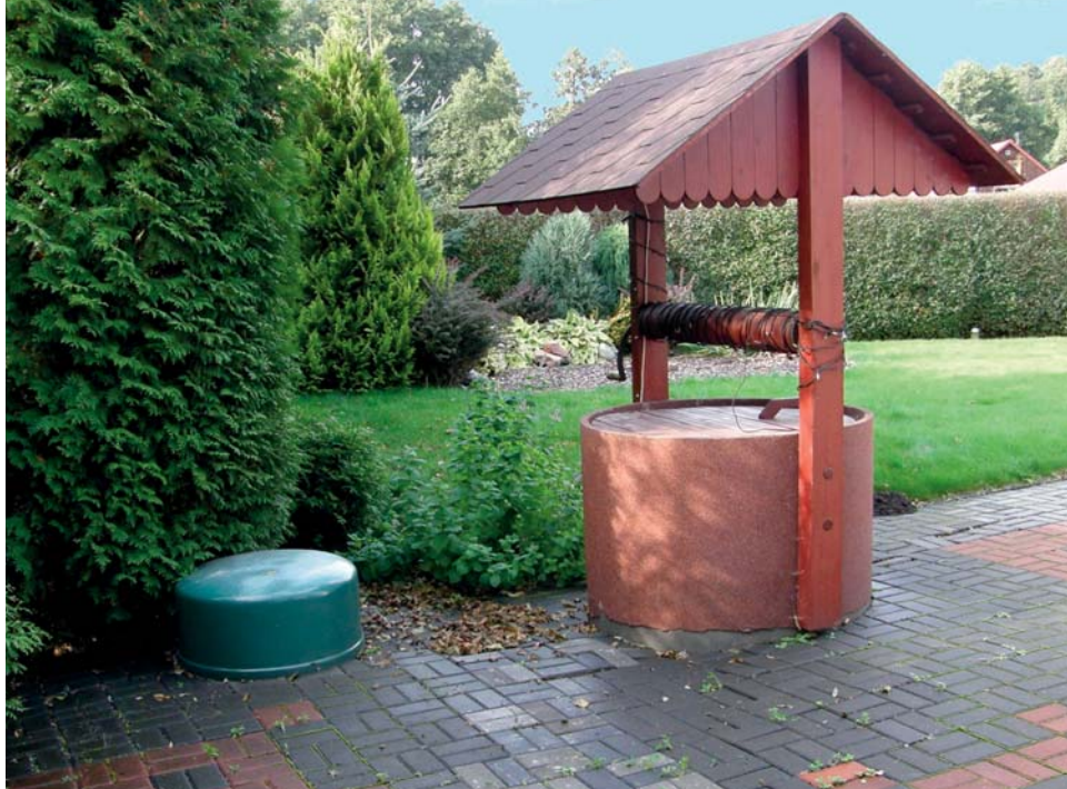
▲ Pompa ciepła (zielona kopuła) jest częściowo zagłębiona w ziemi tuż obok dawnego ujęcia wody
