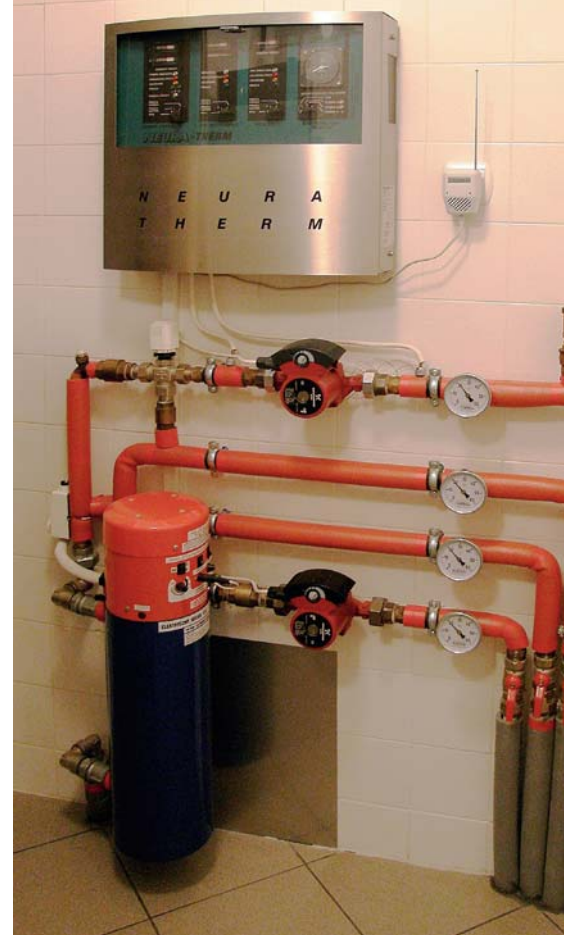
▲ W pomieszczeniu technicznym znajduje się sterownik pompy ciepła Neura, połączony radiowo z programatorem Euroster oraz awaryjny kocioł elektryczny
