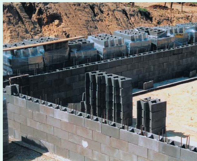
Ściany piwnic można budować np. z betonowych bloczków zasypowych lub z pustaków z wkładką styropianową
