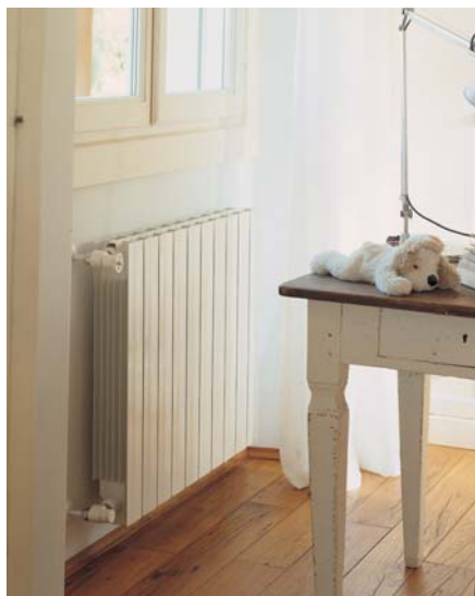
7 Pomiedzy podłogą i parapetem (choć w tym przypadku nie ma go w ogóle trzeba pozostawić min. 10-centymetrowe odstępy (fot. Fondital Nova Florida) ▲
