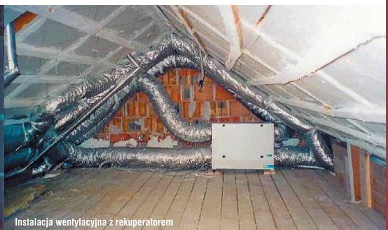
Instalacja wentylacyjna z rekuperatorem
