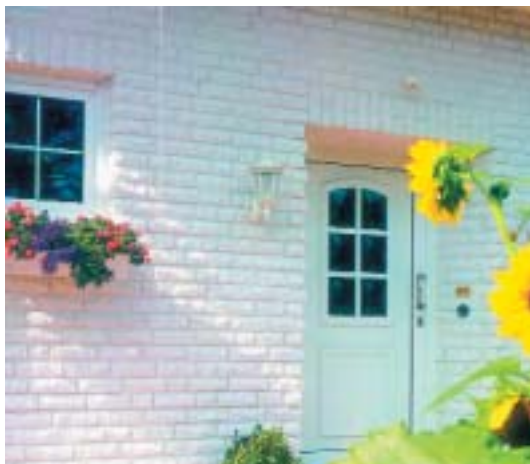
Taka ściana trójwarstwowa wykonana z cegły silikatowej ma wystarczającą izolacyjność cieplną, a także dobre własności akustyczne (fot. Silka)
