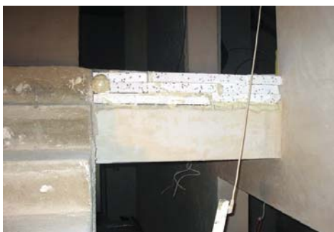
▲ Odchylenia poziomu podłogi wyrównane zostały styropianem, ale na budowie niemal nic nie dzieje się bezkarnie. Okazało się, że podłogi mają poziom niezgodny z planami
