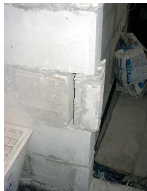
▲ Uderzenie młotkiem w ścianę często kończyło się wypadaniem pustaków. W ściankach działowych brakowało nie tylko kotew! Po dokładniejszym sprawdzeniu okazało się, że spajająca je zaprawa murarska jest co najmniej podejrzana
