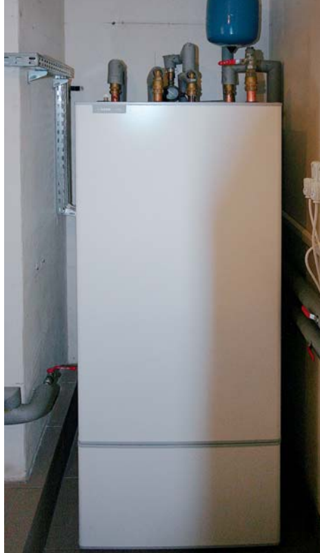
▲ Zbiornik ciepłej wody użytkowej o pojemności 200 litrów, zainstalowany w Myślęcinku
