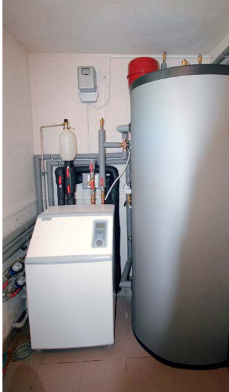
▲ Myślęcinek. Pompa ciepła Nibe Fighter 1140 o mocy 15 kW i 500-litrowy zbiornik buforowy zabezpieczający instalację i będący magazynem ciepłej wody do celów grzewczych
