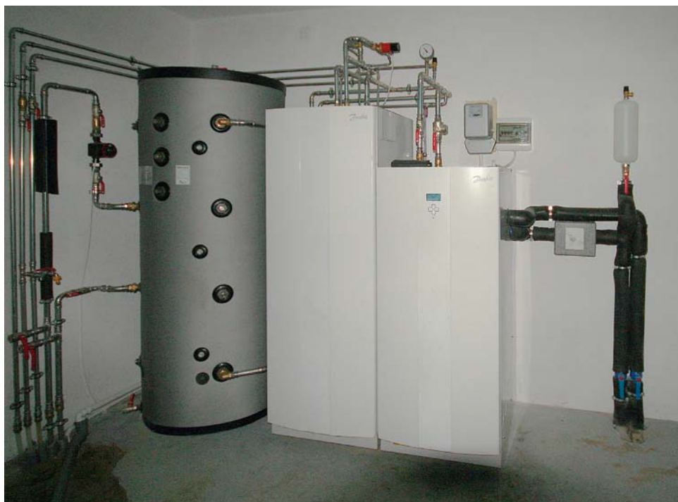
▼ Mrocza. Od lewej strony stoją: zbiornik buforowy (500 litrów), zbiornik ciepłej wody użytkowej (300 litrów) oraz pompa ciepła Danfoss DHP-L o mocy 16 kW
