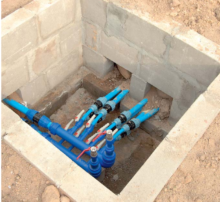
▲ We wszystkich opisanych w artykule przypadkach sondy pionowe doprowadzone są do murowanej studzienki zbiorczej, która jest połączona z pompą ciepła w budynku
