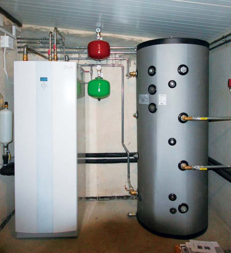
▲ Raciąż. Pompa ciepła DHP-H produkcji firmy Danfoss o mocy 16 kW, która jest zintegrowana ze zbiornikiem c.w.u. o pojemności 180 litrów
