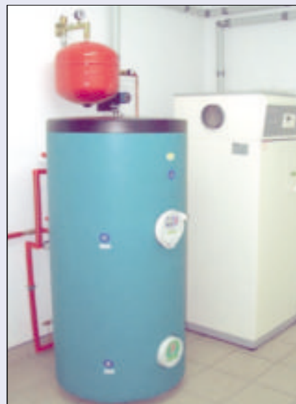
7 Solarny zbiornik c.w.u. i kompaktowa pompa ciepła (fot. Archiwum Polska Ekologia)
