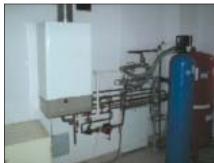
■ Jedną z wad, ujawnionych podczas mieszkania, jest to, że inwestorzy nie wykonali instalacji do wymuszonego obiegu ciepłej wody. Ale sam piec gazowy Junkers sprawuje się bez zarzutu ■
