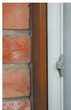
Okno uszczelnione pianą rozprężną – strona zewnętrzna
