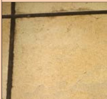
10 Skutki spoinowania bez zabezpieczenia brzegów płytek
