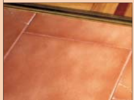
2 Skutki niedostatecznej wytrzymałości płytek przy niepełnym podparciu zaprawą
