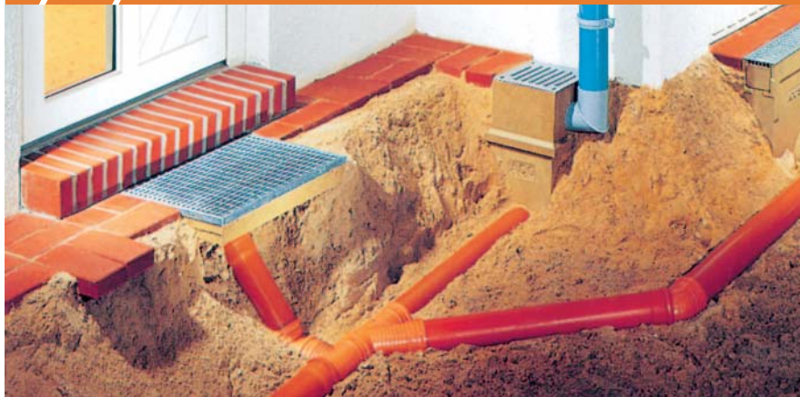
10 Odwodnienie liniowe; widoczne połączenie rury spustowej ze studzienką (fot. ACO Elementy Budowlane) ▲
