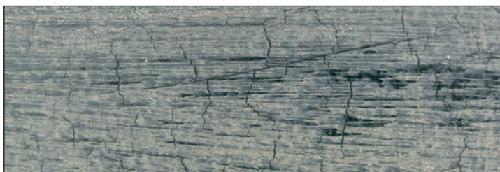
• Stare izolacje bitumiczne na bazie smoły
