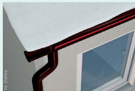
Kabel grzejny ułożony na dnie rynny ochroni ją przed zaleganiem śniegu i zamarzaniem wody
