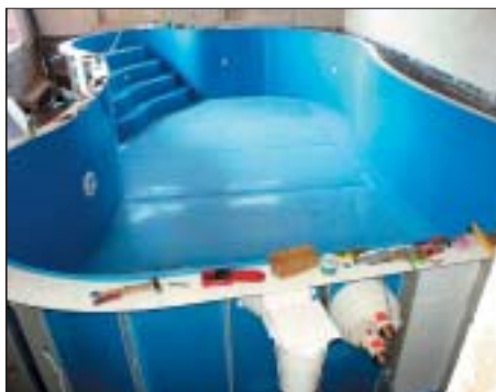
4 Niecki z płyt polipropylenowych barwionych w masie na kolor niebieski są montowane również wewnątrz budynków (fot. Horn)
