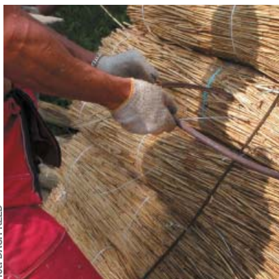
fot. DACH REED
