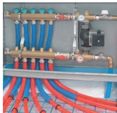
▲ Rozdzielacz schowany w szafce podtynkowej
