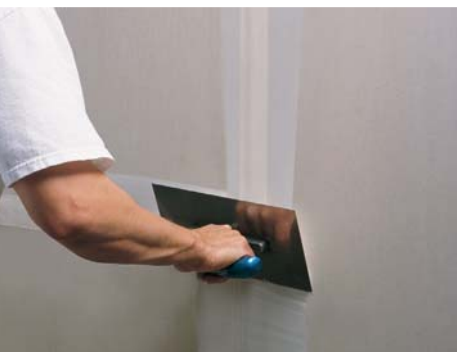
Nakładanie trzeciej warstwy masy – ok. 5 cm szerzej niż poprzednia. Nierówności trzeba zeszlifować droбноziarnistym papierem ściernym
