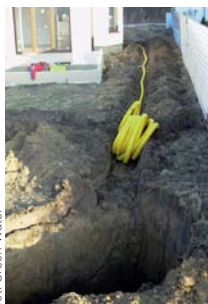
foto: Green Water Rura drenarska doprowadzająca deszczówkę do studni chłonnej
